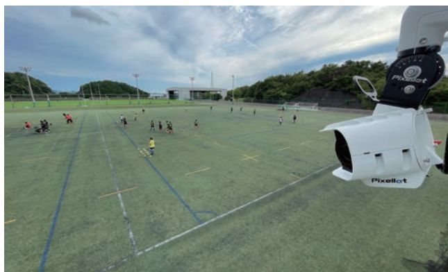
▲上富田多目的グラウンドAIカメラ設置写真
