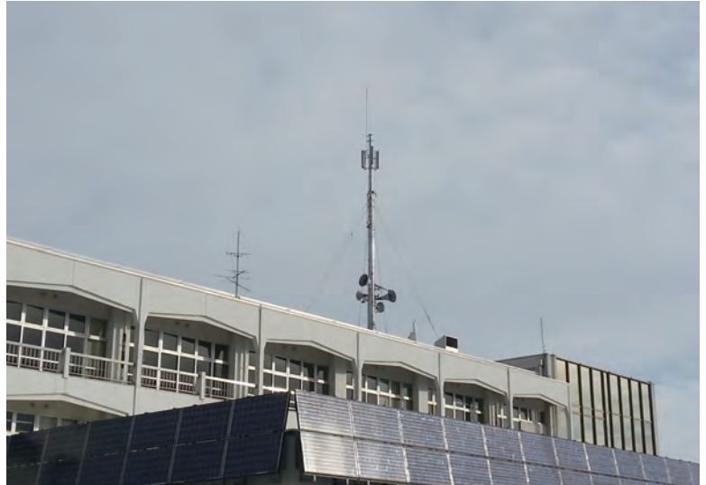
◀役場庁舎屋上に設置されたWIMAX基地局
