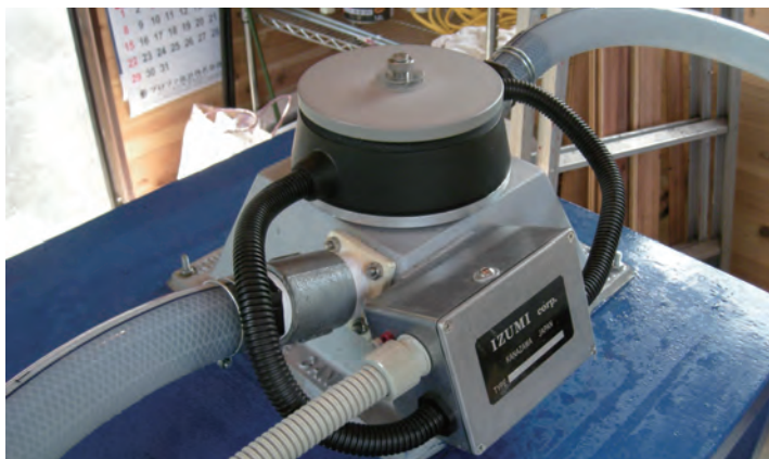
▶設置された小水力発電機
